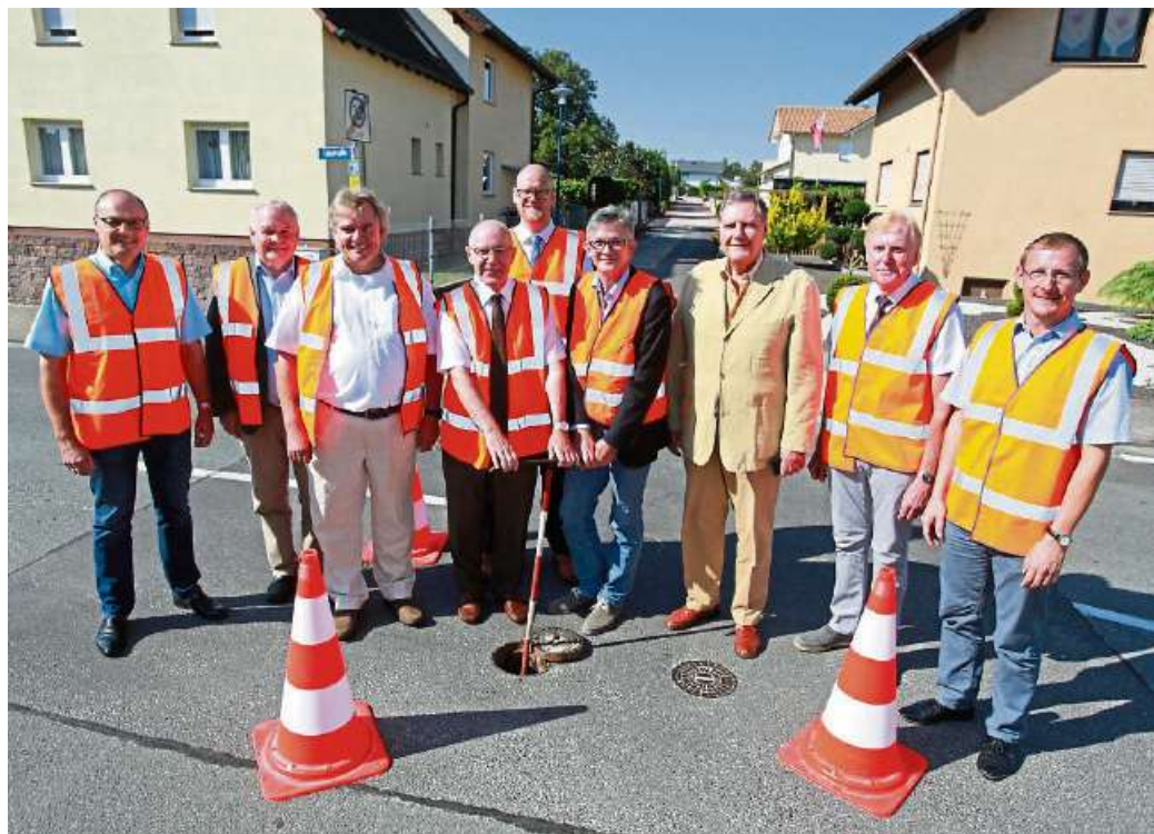
WVR-Geschäftsführer Willi Kiesewetter (4.v.l.) nahm gemeinsam mit VG-Bürgermeister Ralph Spiegler (4.v.r.), Ortsbürgermeister Thomas Barth (r.) und Vertretern der WVR und der ausführenden Baufirmen die neue Transportleitung in Betrieb.
